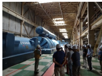
武豊火力発電所タービン室
