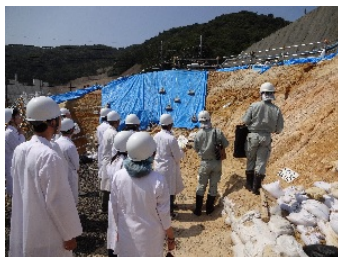
砕帯調査現場
